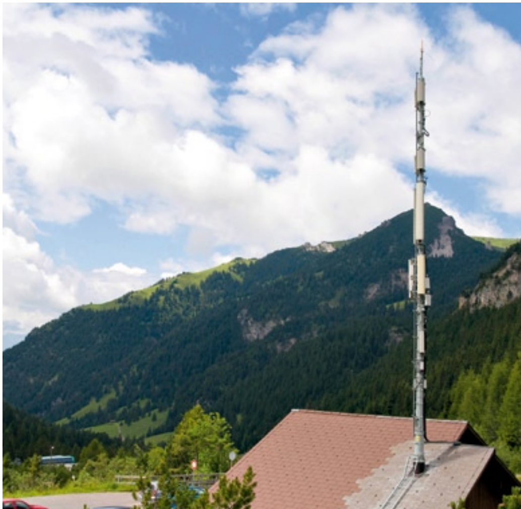
Tiefere Grenzwerte, mehr Antennen: Mobilfunkmast im «Ländle».
