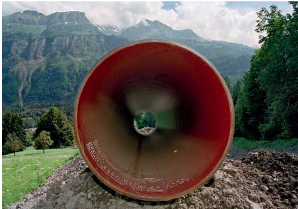
Energie der Zukunft: Gasleitung im Kanton Bern.
