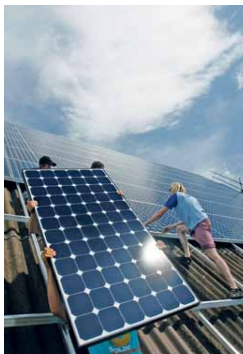
«Mehr Markt»: Solarpanels.
