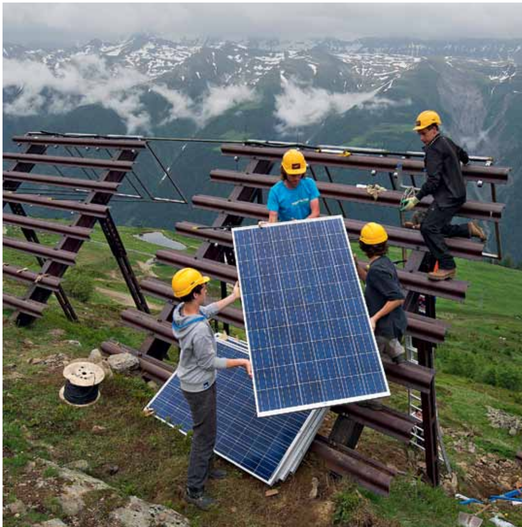
Zu welchem Preis auch immer: Photovoltaik-Anlage im Wallis.
