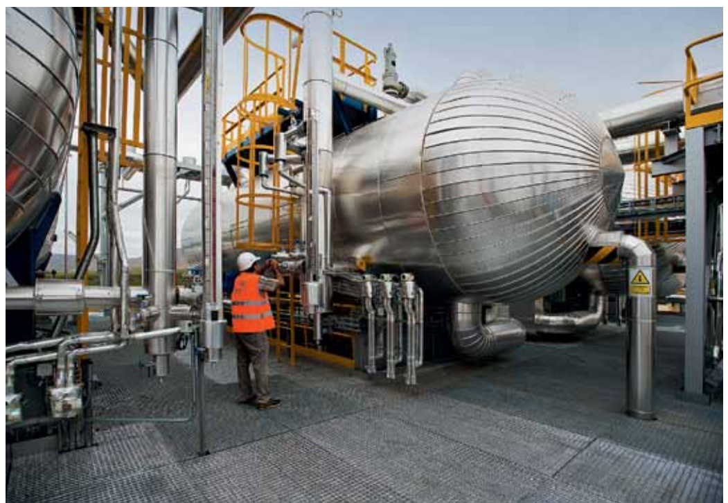
Der Fotovoltaik überlegen: Dampfspeicher in Puerto Errado.
