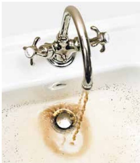
Rostwasser im Lavabo deutet auf die Alterung der Trinkwasserinstallation hin.
