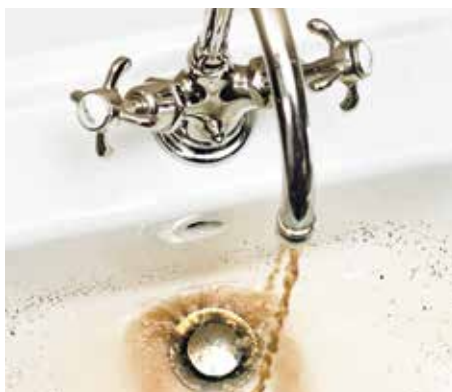
Rostwasser im Lavabo deutet auf die Alterung der Trinkwasserinstallation hin.
