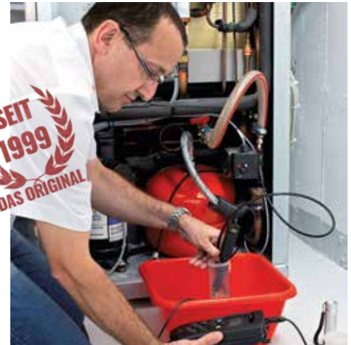
Das HAT-System ist seit 1999 im Einsatz.
