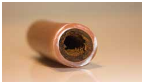
Versprödetes und verschlammtes Bodenheizungsrohr.
