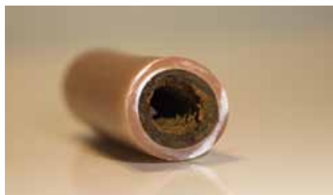
Versprödetes und verschlammtes Bodenheizungsrohr.
