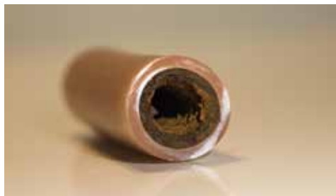
Versprödetes und verschlammtes Bodenheizungsrohr.
