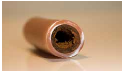
Versprödetes und verschlammtes Bodenheizungsrohr.
