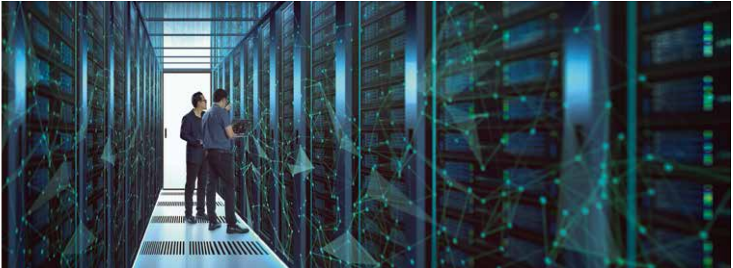
Zu den Massnahmen gehören Konnektivität, Wärmepumpen, Smart-Building-Managementsysteme, Daten-Clouds.
