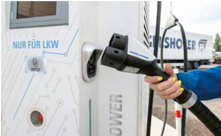
Hochgerüstet: LKW-Schnellladesäulen für hohe Belastung.
