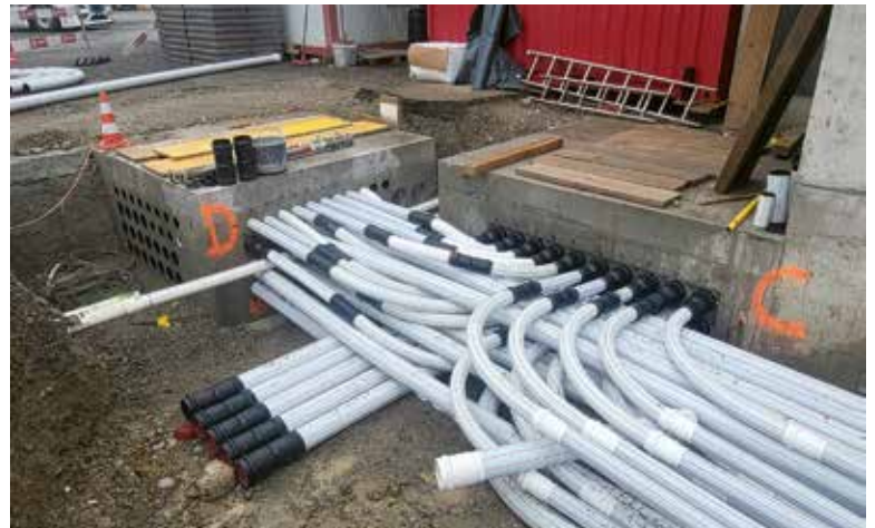
Kein Kabelsalat: umfangreiche Installationen für die Stromflüsse.
