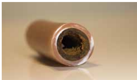
Versprödetes und verschlammtes Bodenheizungsrohr.
